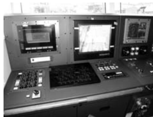
消防装置制御盤
