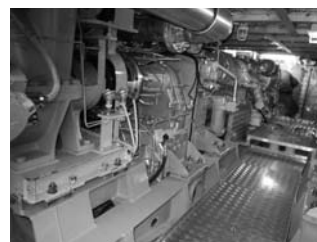
主機・減速機・消防ポンプ
