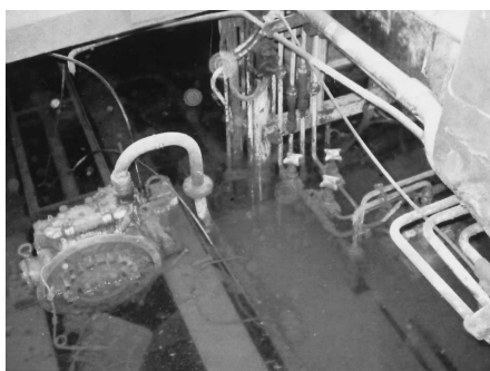
修復前の機関室 (浸水状態)
