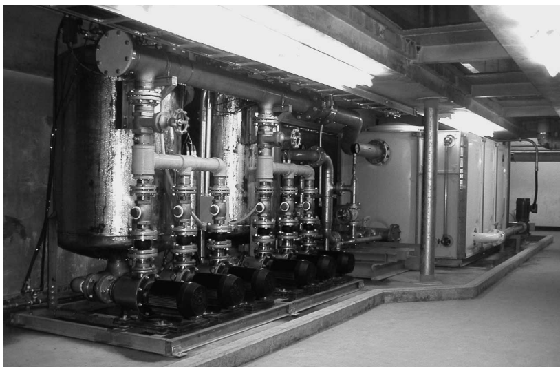
写真-1 脱気装置全景
