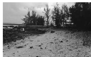
高潮で崩れたヘリポート
