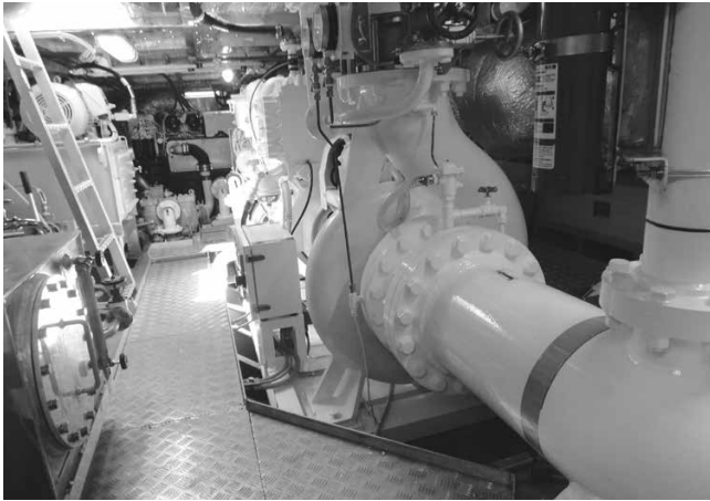
原動機付消防ポンプ
